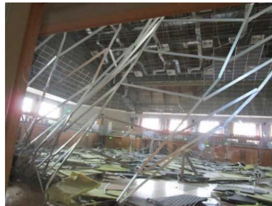
体育館における天井の損傷
