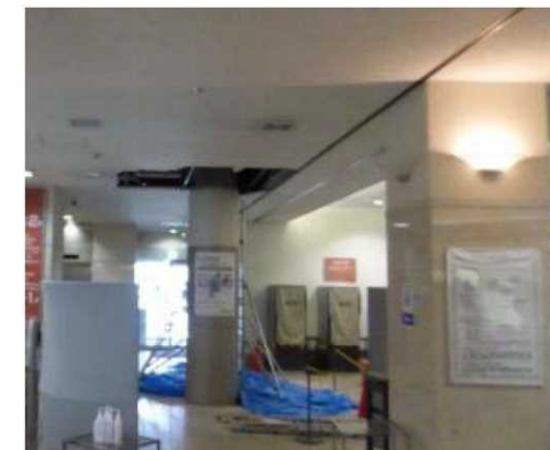
病院における天井の損傷
