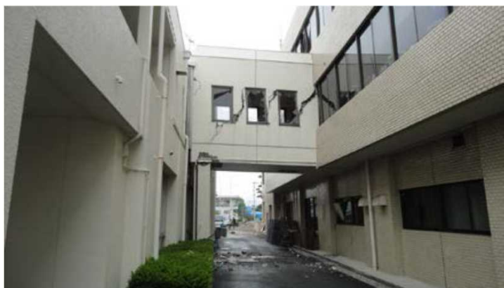
庁舎における構造部材の損傷
